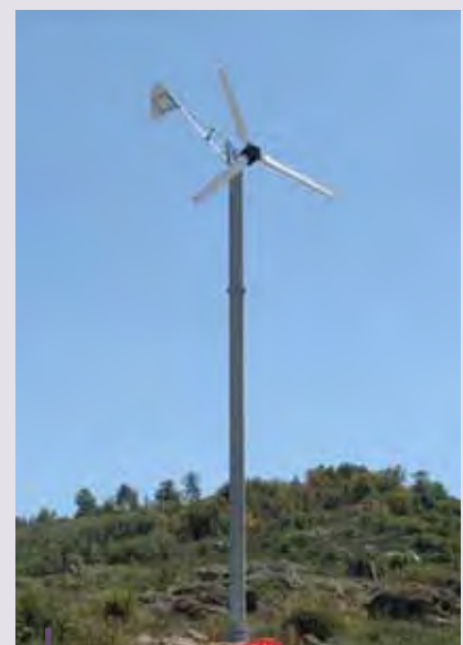
Micro éoliennes produisant de l'électricité. Grâce à leur légèreté, leur petite taille et la souplesse de leur configuration, elles peuvent être installées à la fois dans des environnements urbains et ruraux.
